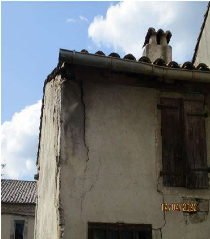
Procédures de mise en sécurité (ex péril)
